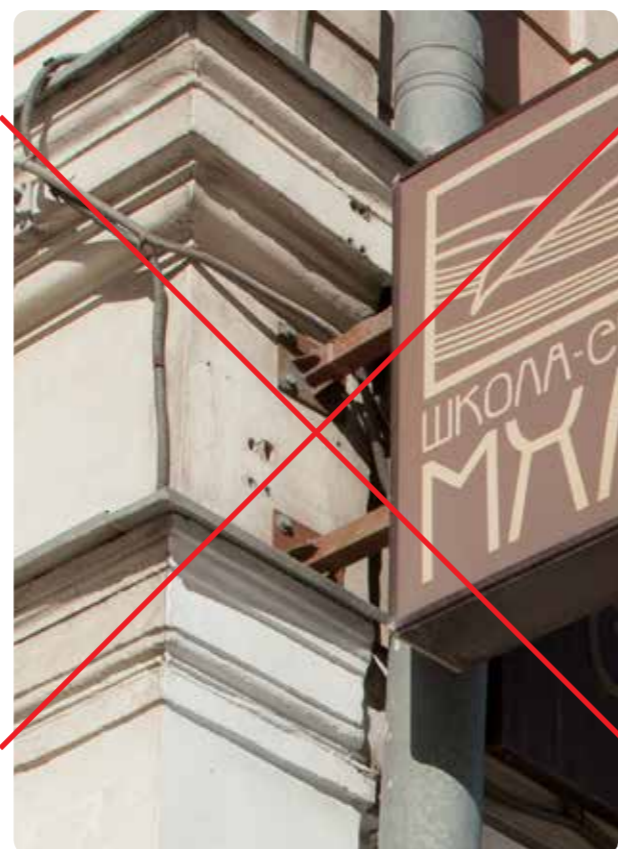
Покрытое ржавчиной крепление с бросающимися в глаза элементами крепежа, установленное на неподготовленном участке фасада (видны отверстия от креплений предыдущей вывески)
