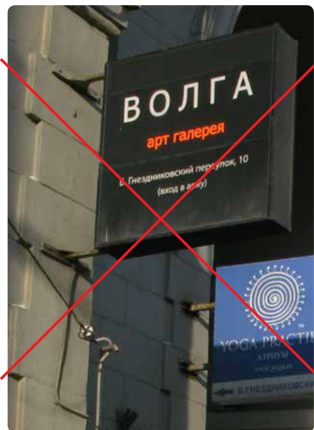
Небрежно выполненные крепления, покрытые ржавчиной
